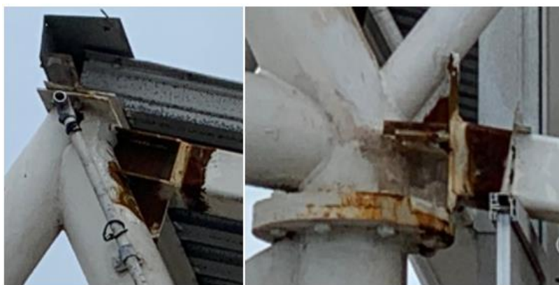
Figuur 4-13 Vakwerkligger 42, links: 42-1 en 42-2, rechts: 42-3 en 42-4. De coating is voor niet-destructief onderzoek gedeeltelijk verwijderd. Dit verklaart de corrosie.
