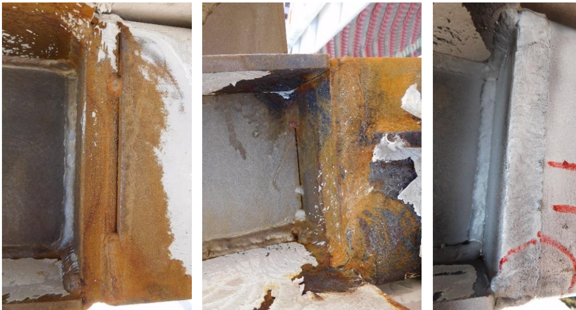
Figuur 4-20 Van links naar rechts: Het ontbreken van lassen bij respectievelijk vakwerkliggers 46, 47 en 50.
