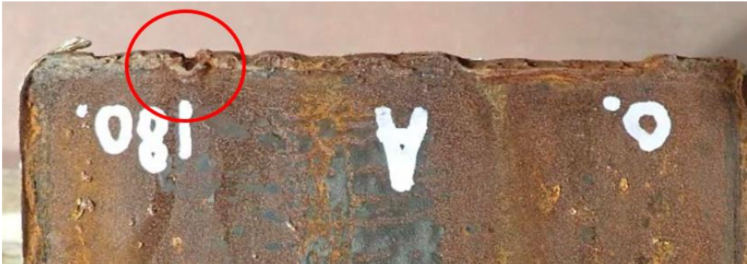
Figuur 4-26 Putcorrosie koplaat bovenverbinding vakwerkligger 40, las A. Foto van INTRON.
