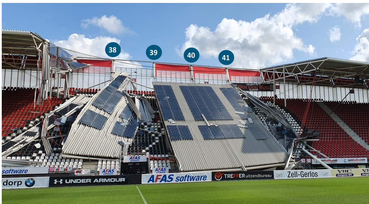
Figuur 2-7 Schade na de instorting inclusief de nummers van stramienlijnen
