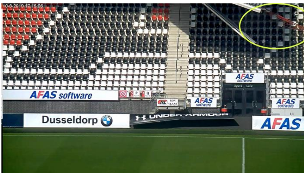
Figuur 4-6 Kabels tussen vakwerkliggers 38 en 39 staan strakgespannen richting rechtsonder (Tijd: 17:15:06)
