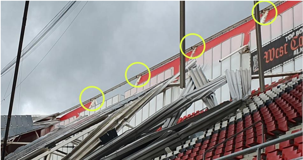
Figuur 2-12 Breukvlakken in de vakwerkliggers bij aansluiting van de bovenregels op de kopplaten
