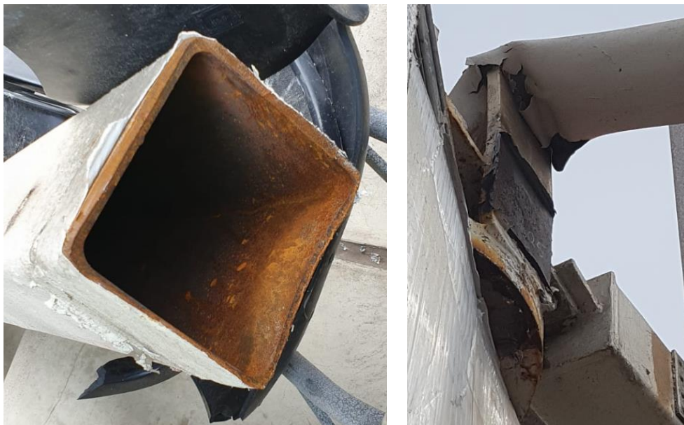
Figuur 2-16 Links: corrosie aan de binnenzijde van de onderregel van vakwerkligger 39, rechts: corrosie bij de kopplaat van de onderregel van vakwerkligger 41.
