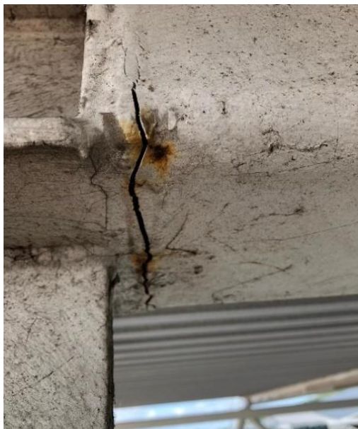
Figuur 4-31 Scheur in de onderzijde van de bovenverbinding van vakwerkligger 43 die vermoedelijk vergelijkbaar is met de aanwezige scheur in vakwerkligger 40 voor de instorting.
