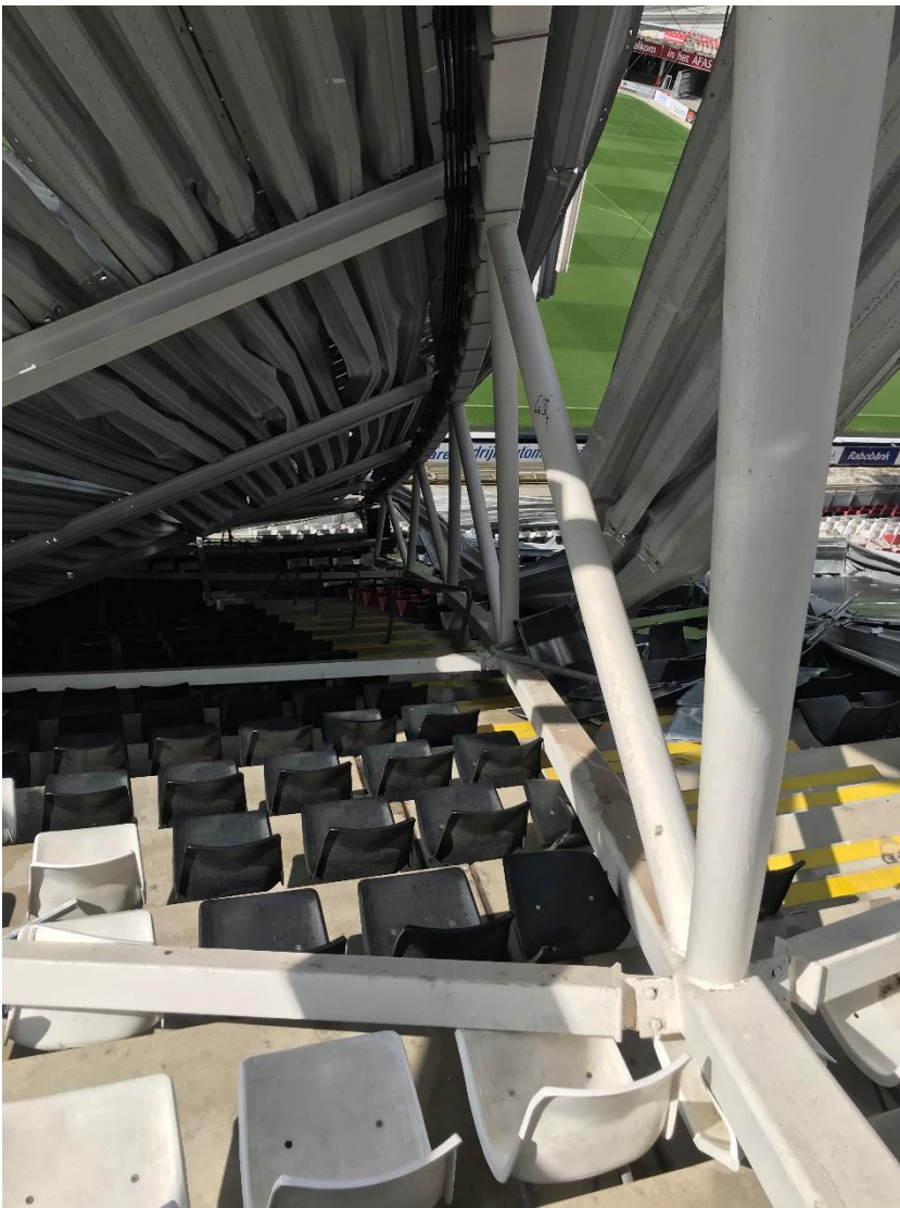
Figuur 2-9 Vervorming uit het vlak van vakwerkligger 38
