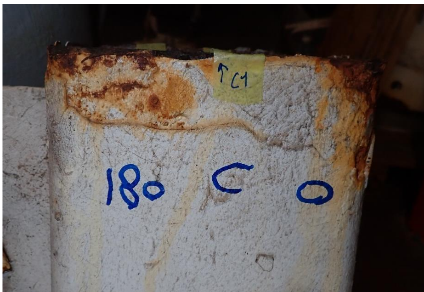
Figuur 4-18 overschilderde corrosie bij verbinding 40-1/2 zijde C waar opnieuw corrosieproduct doorheen komt.
